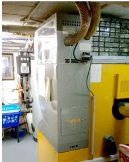
Pelletkessel in niedrigem Kellerraum.
