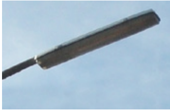
Die alten Leuchten, die nun ersetzt wurden.
